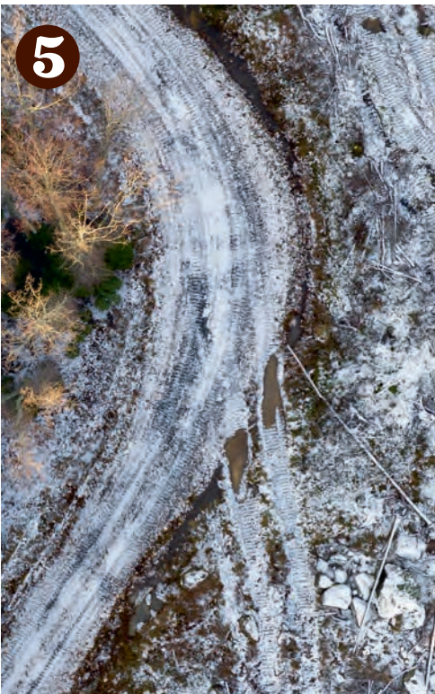
Allt detta har gjorts under den blötaste perioden på året, med massiva regnmängder. Längre vägsträckor är sönderkörda, eftersom vägar med denna tillgänglighetsklass bara håller vid tjäle (inträffar sällan i Uppland) eller vid mycket torra förhållanden.
