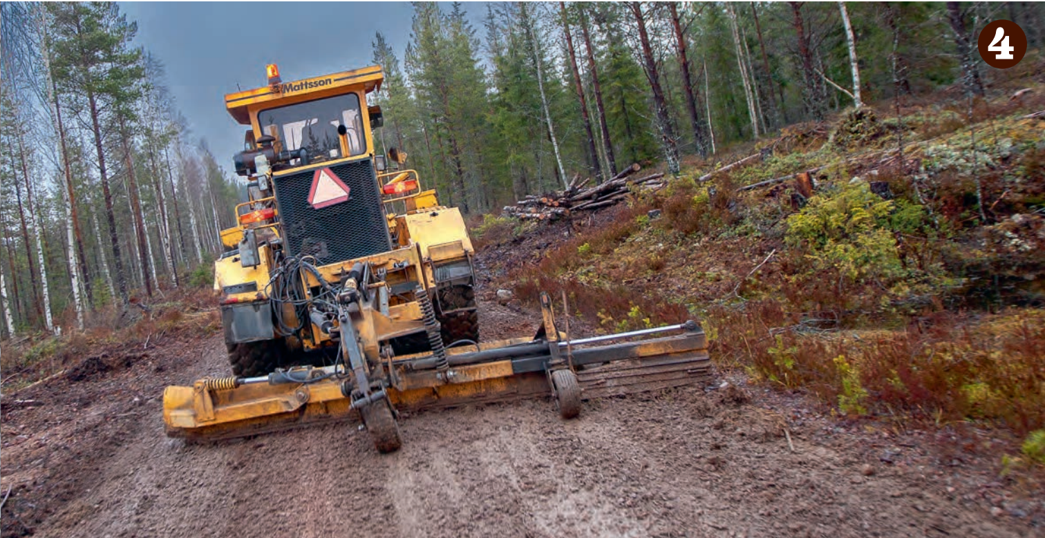
Uppe på vägen har skotarbanden klöst upp finjordsrikt material som blandats med det tunna gruslagret. Det sänker bärigheten ytterligare och uppblandningen permanentas då väghyveln dyker upp.
